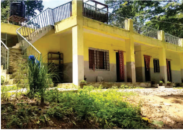
जीर्ण अवस्थामा रहेको भवनको माथिल्लो तल्ला हटाई तल्लो तल्ला मर्मत सुधार (पानीमुहान)
